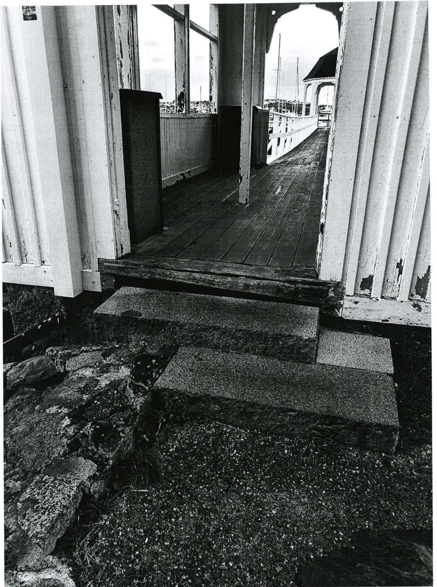
Bil. 1 Utgång Kallbadhuset. (obs. Rotten tröskel)
