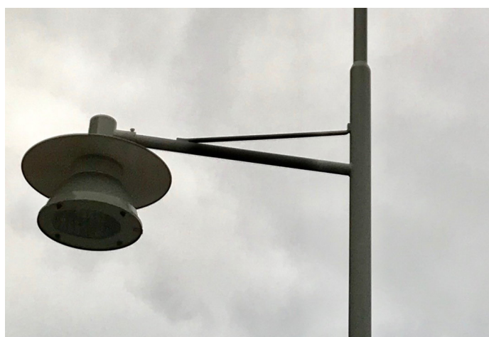
Befintlig stolparmatur längs med Norra Hamngatan, Drottningatan och delar av Landsväggsgatan. Foto: Ateljé Lyktan.
